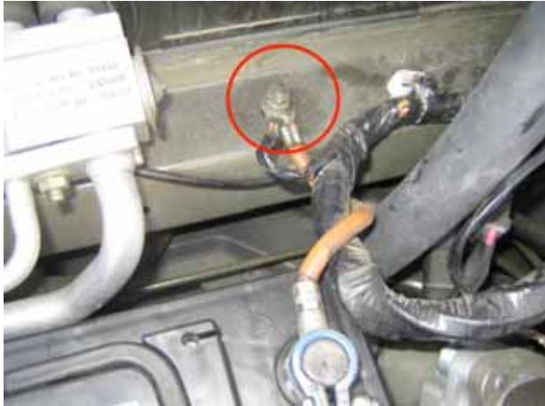
(1) Direkt hinter dem Minuspol der Batterie.
